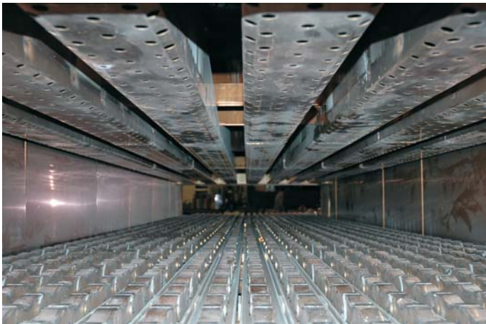
Bild 4: Blick in den Nutzraum eines Jet-Heating-Ofens mit viersträngigem Kettentransport und in der Decke angeordneten Düsenfeldern
