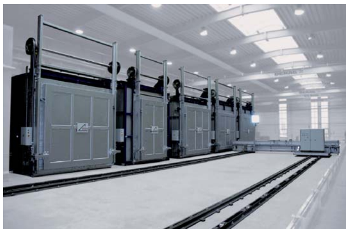
Bild 8: Kammer-Ofenanlage mit Jet-Heating
